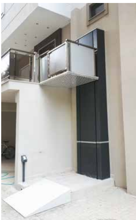
Plattformlift im Aussenbereich
